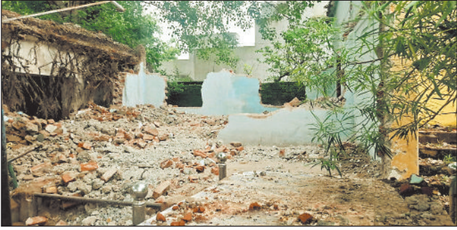
डिस्मेंटल स्कूल भवन, जर्जर स्कूल भवन।
